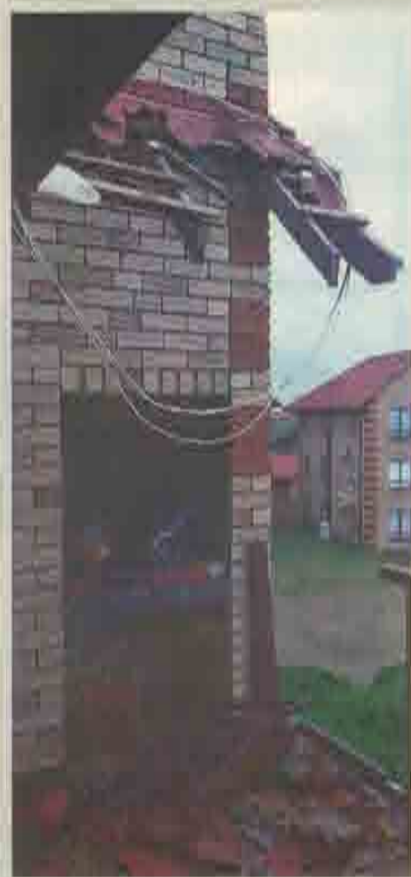
Die skade is duidelik sigbaar waar weerlig die afdak van 'n woning by Beacon Point raakgeslaan het.
